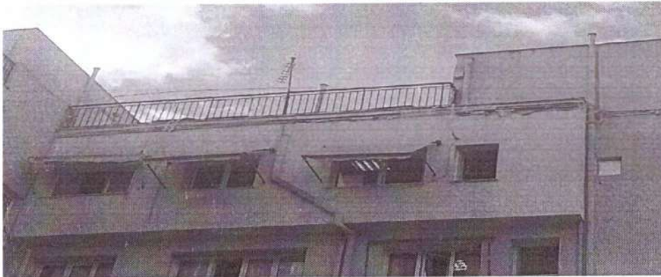
1. Στηθαίο κτιρίου με έντονες φθορές – διαβρώσεις
